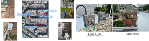
침수감지센서 설치(4개소) 게이트웨이 설치(관리사무실 상부)
