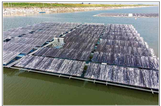
[그림 1] 조류 분변으로 뒤덮인 새만금 수상태양광 발전소
