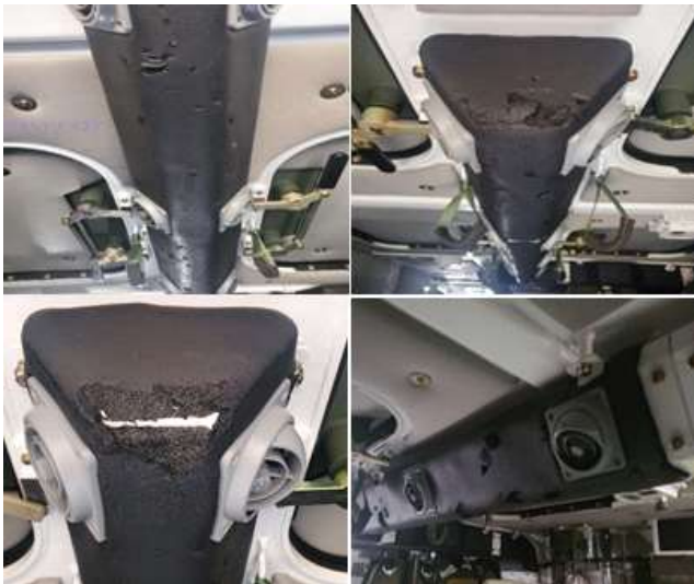
그림 1. 실제 차량의 단열재 손상 형상
